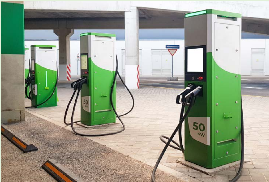
Cargadores para coches eléctricos
